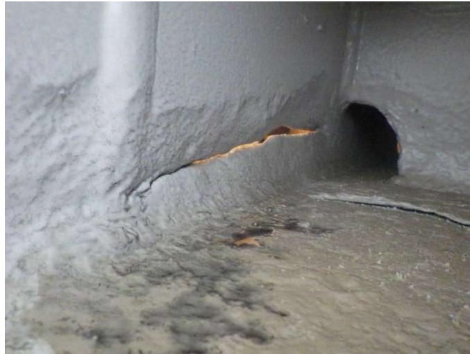
Fissure à proximité d'un appui du pont sur le Rhin.
